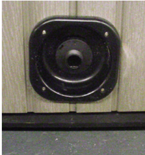
Figura 12. Válvula de drenaje instalada en el gabinete
